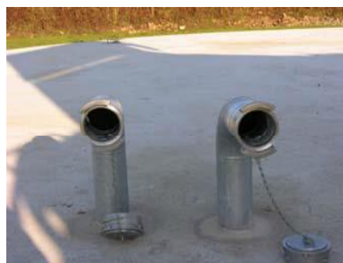
Colonnes d'aspiration (sur citerne enterrée)
